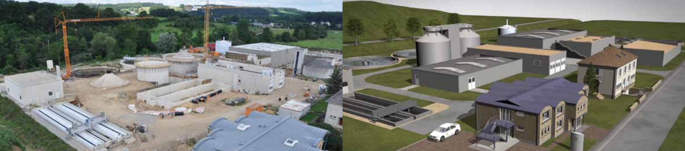
Chantier du projet de modernisation et d'extension de la station d'épuration de Beringen-Mersch et Simulation 3 D
