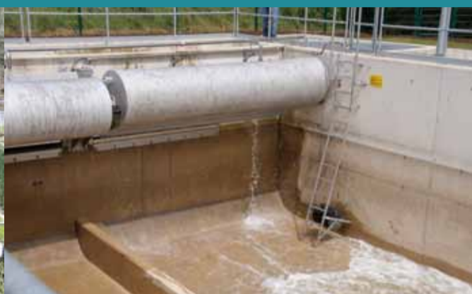
Rinçage automatique du bassin d'orage à Buschdorf
