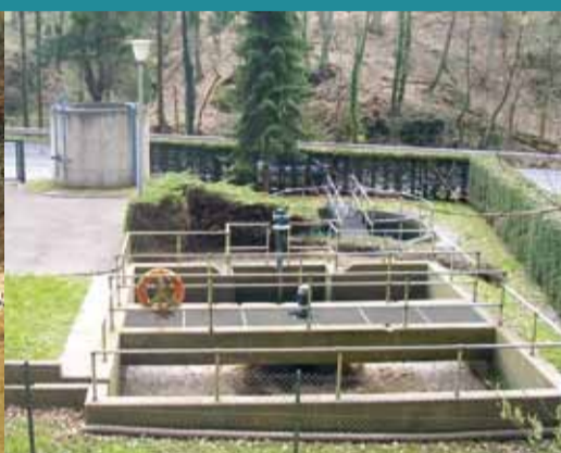
Station d'épuration, Angelsberg
