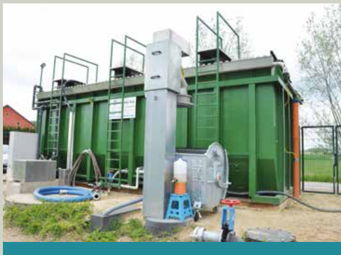
Schwebach - station d'épuration provisoire / provisorische Kläranlage
