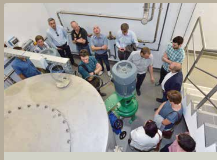
Station de pompage - Léisbéch Pumpwerk
