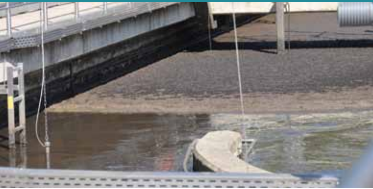
Beringen, bassin à boues activées / Belebtschlammbecken
