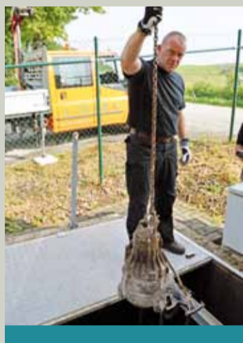
Contrôle d'une pompe submersible Kontrolle einer Tauchmotorpumpe
