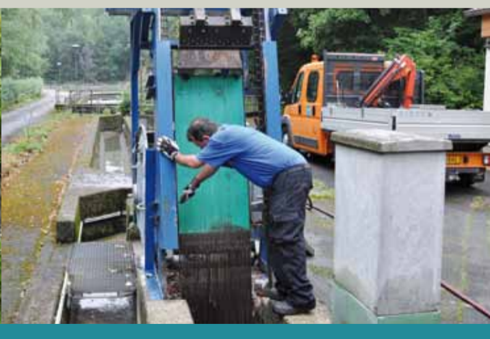
Entretien du dégrilleur STEP Steinfort Wartung des Feinrechen STEP Steinfort
