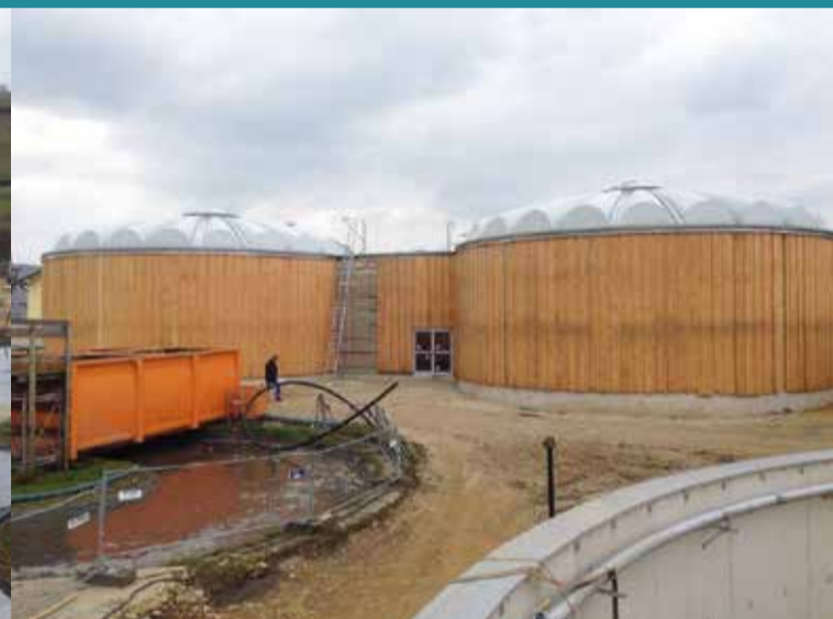
Schlammeyndicker Kläranlage Junglinster / Station d'épuration de Junglinster, épaisseur de boues.
