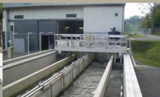
Boevange, Dessableur-dégraisseur / Sand und-Fettfang
