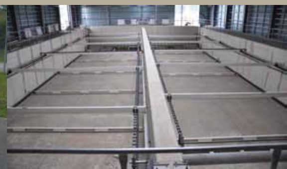
Beringen-Mersch, traitement primaire / Vorklärbecken
