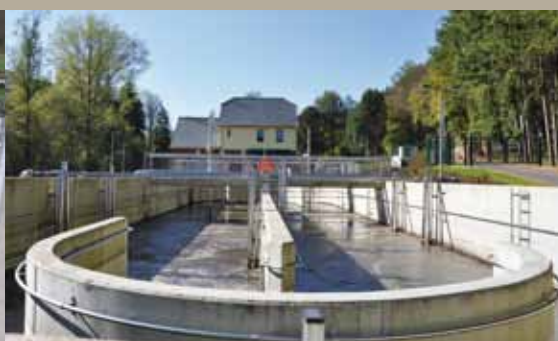
Kopstal, traitement biologique / Belebungsbecken
