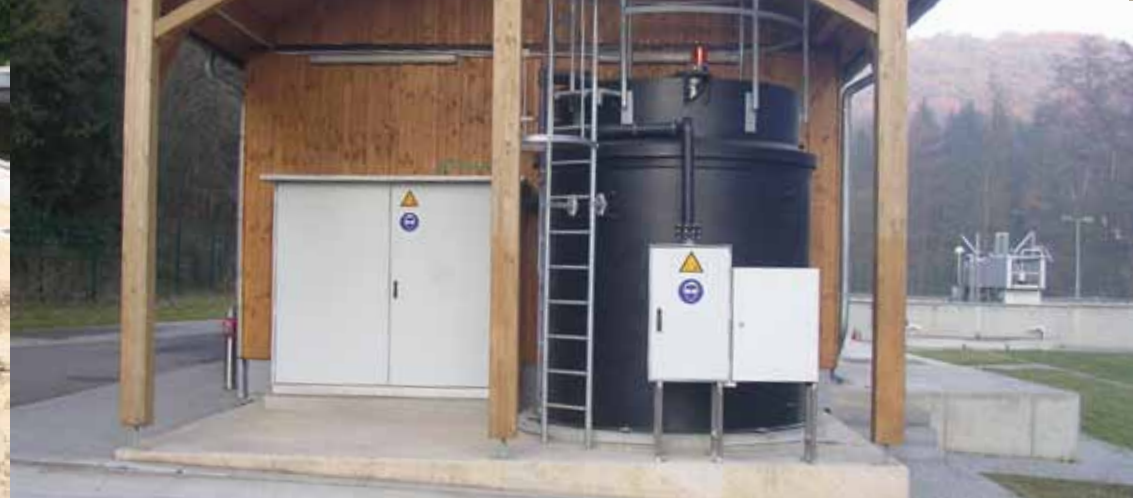
Kopstal, installation de déphosphatation / Phosphatfällung
