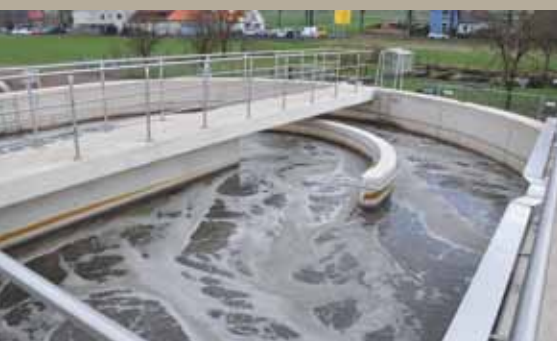
Beringen-Mersch, traitement biologique / Belebungsbecken
