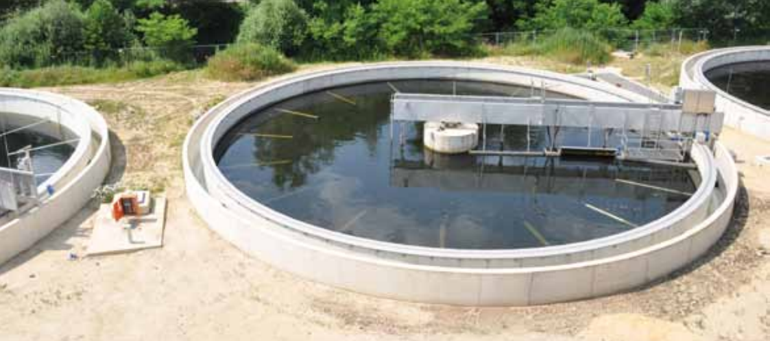
Beringen-Mersch, bassin de décantation secondaire / Nachklärbecken
